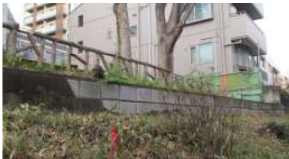
側面コンクリートの剥がれ
