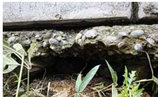
土留め下の空洞
