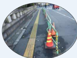
例：曲がったガードパイプ
