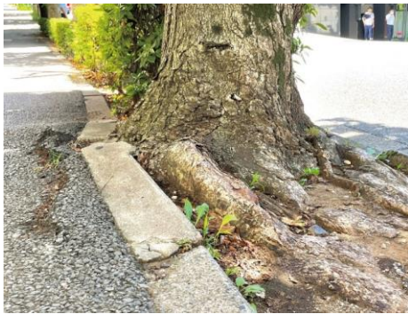
根張りが縁石を持ち上げる状況
