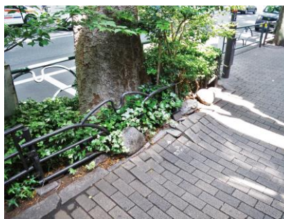
根上がりの発生状況
